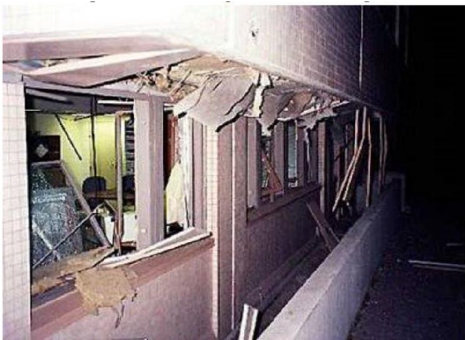
Kuva 2 Poliisitalon seinä autopommin räjähdysten jälkeen, Pasilankadun puoli.
