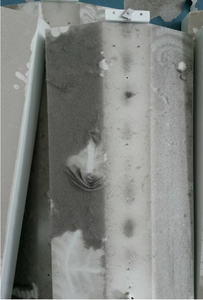
Kuva 1. Testauskohteen kiskokiinnitteisten kattovalaisimen yläpinta, valaisimia 72 kpl => siivoustaso-ongelma, suunnitteluvirhe vai molemmat yhdessä?
